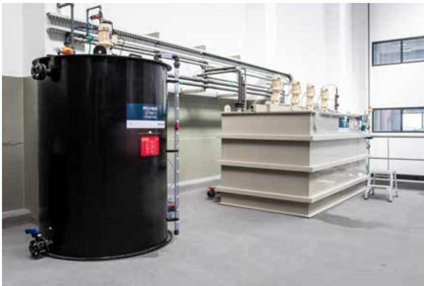
Zoutman: roertanks om proces- & pekewater te hergebruiken (ultrafiltratie (UF)-concentraat tank, flocculator tank, decantor tank en slibtank)
