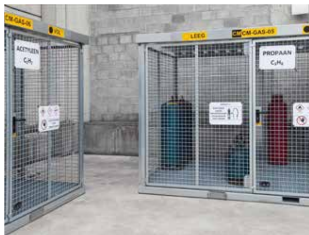
VPK Packaging Group: afsluitbare gasflessenopslag
