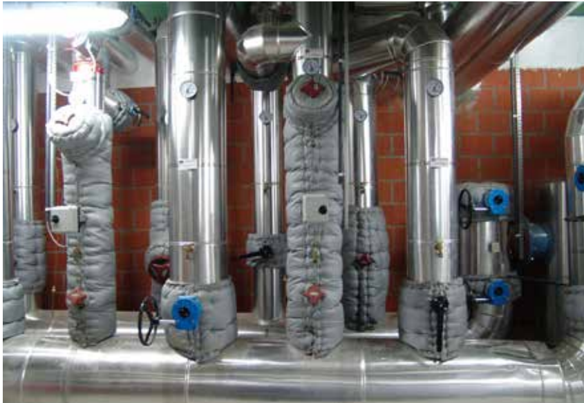
Isolatie van afsluiters d.m.v. isolatiemantels
