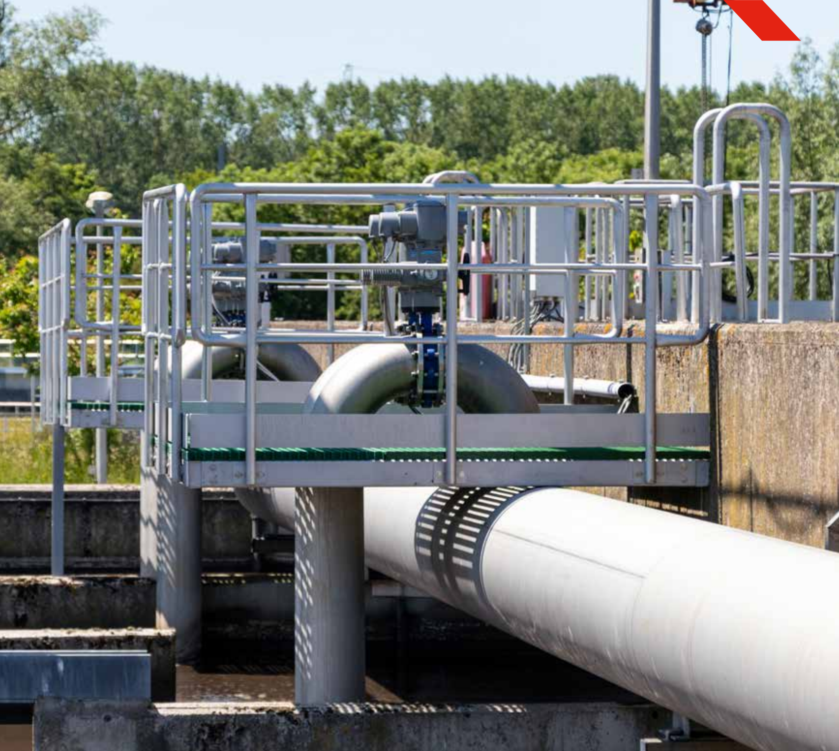
Aquafin: 8 bordessen bestaande uit GVK roosters en leuningen en ladders uit RVS (inox)
