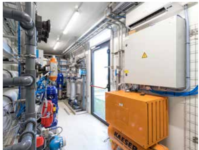
De Blanckaert: mobiele container met doseer- en behandelingsgedeelte
