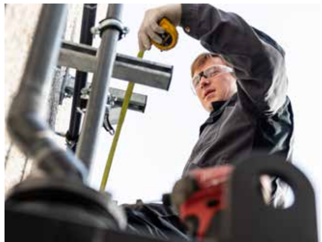
De Brabandere: kunststof piping en supportering bij een installatie met HCL
