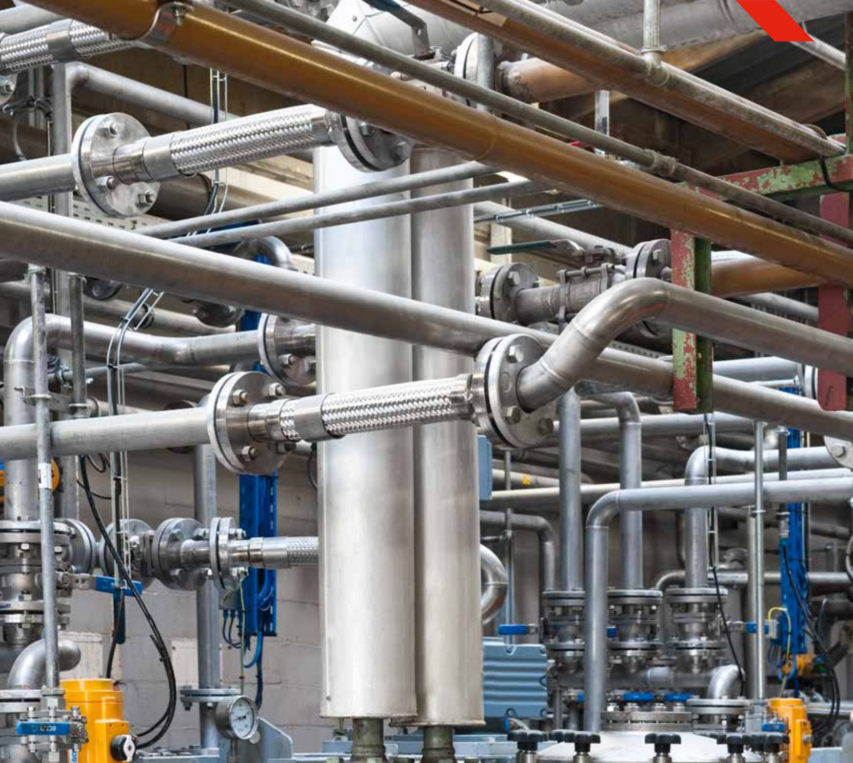
Umicore: RVS piping
