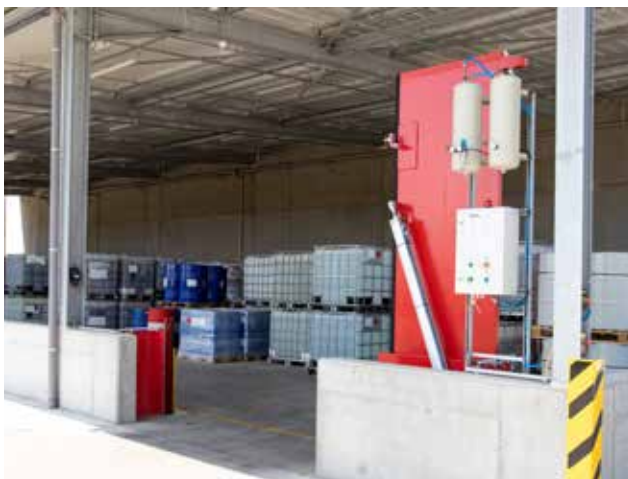
DNCP: volautomatische barrière voor het vloeistofdicht maken van de opslagplaats met chemische stoffen
