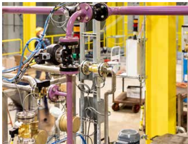
Ferro Pigments: 3 kilometer aan piping in staal, RVS en kunststof met dubbelwandig leidingwerk voor de meest agressieve chemicaliën
