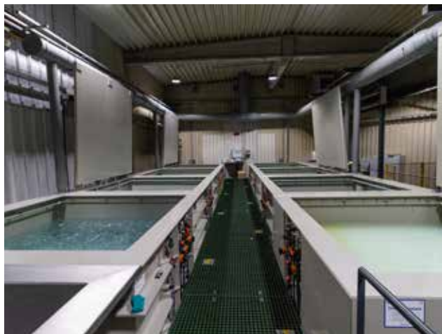
IGW: installatie met 8 procesbaden in PP en 1 bad in RVS
