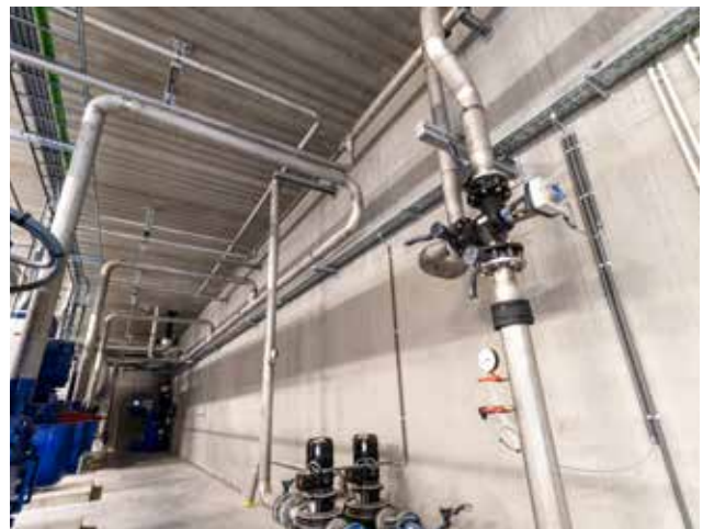
De Coster: RVS leidingwerk met heel specifieke lastechniek voor ammoniak
