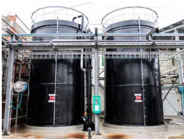
Rousselot: 2 dubbelwandige HDPE tanks voor HCL en NaOH
