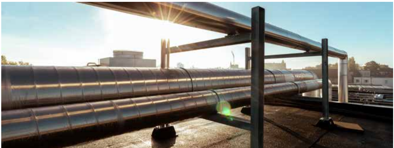
De Coster: isolatie van ventilatiekanalen
