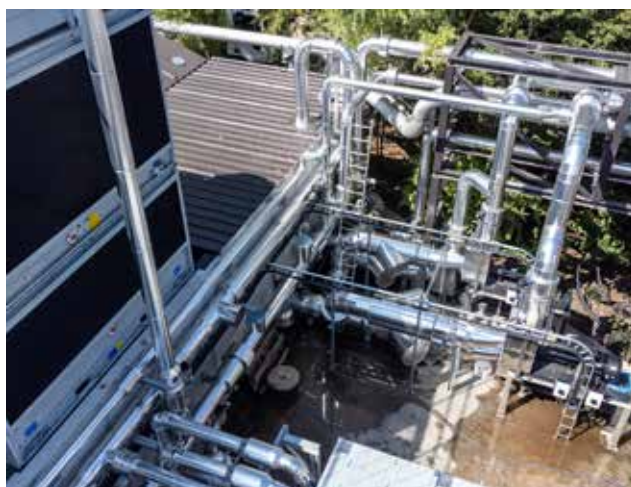
BioBase: isolatie van leidingen hier nog meer info
