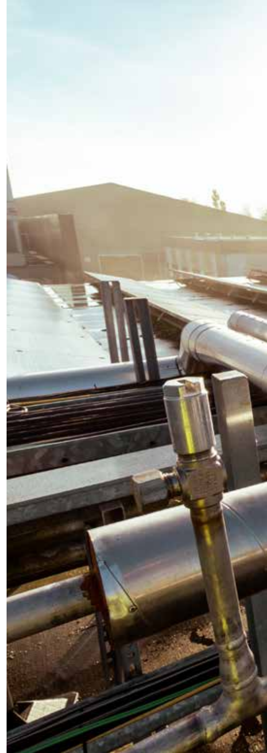
De Coster: isolatie van ventilatiekanalen
