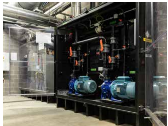
Induss: pompstation voor de controle van het debiet van chemicaliën
