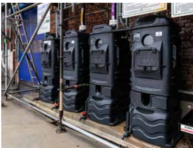
Rousselot: vulkasten met sturing, zodat een tankwagen zijn lading veilig kan lossen in een opslagtank
