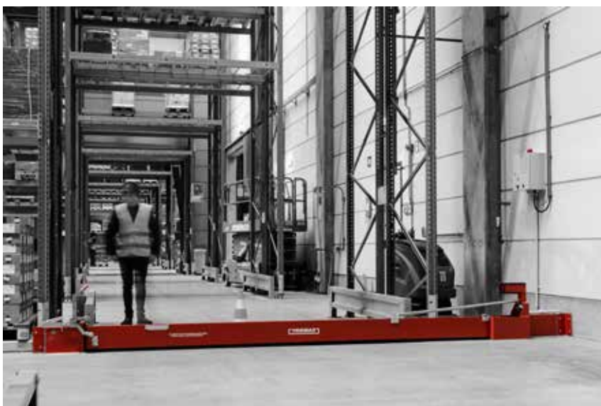
Bison: installeren van een verticale vloeistofbarrière voor de opvang van bluswater
