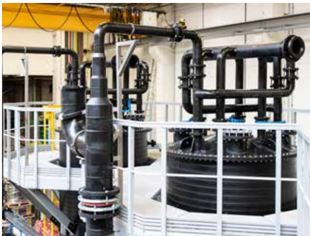
Waterleau: gaswassers uitgerust met koolladders, bordessen en leuningen uit GVK
