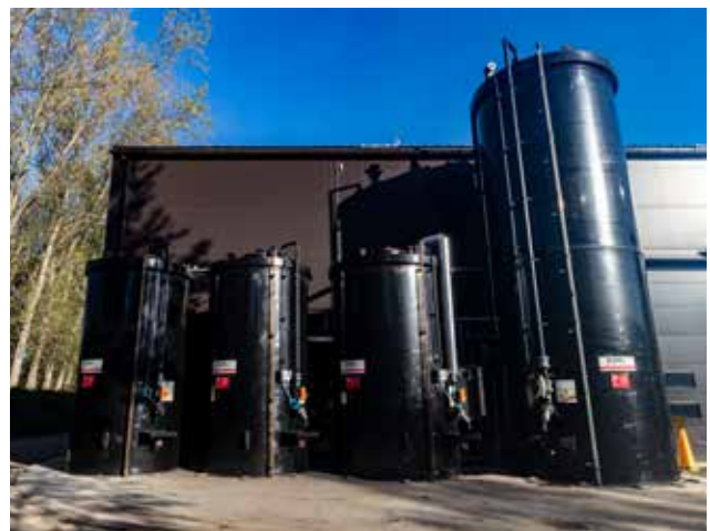
Biobase: 4 dubbelwandige kunststoftanks met pompkasten voor ammoniak, natriumhydroxide, fosforzuur en zwavelzuur
