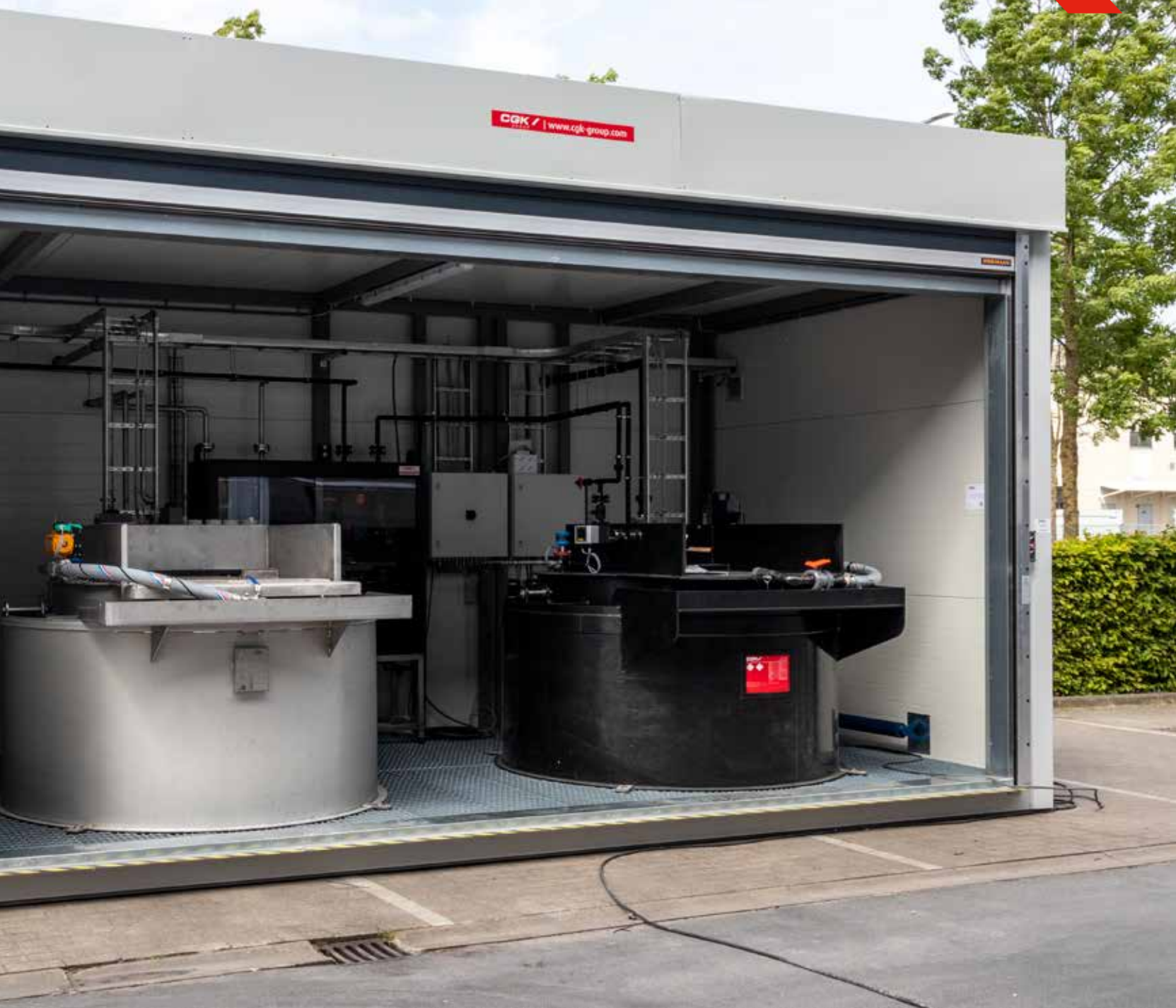
Shell: doseerinstallatie in een zuurbestendige geïsoleerde opslagcontainer
