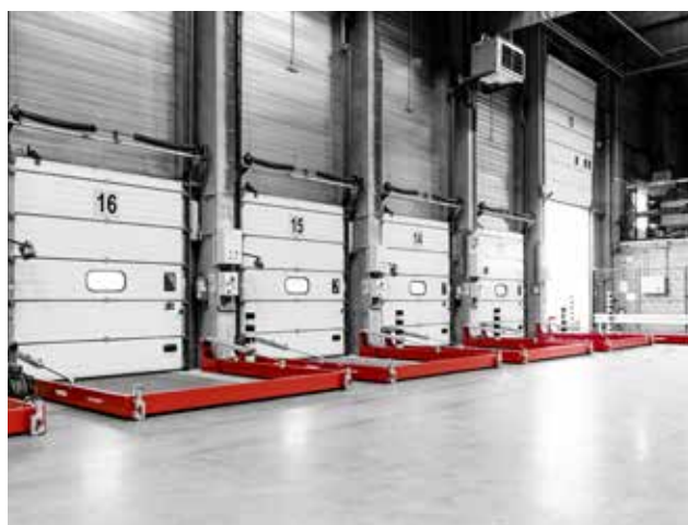
Cummins - Rumst: volautomatische laadkaaibarrières voorzien van lekdetectie en gekoppeld met de brandmeldcentrale
