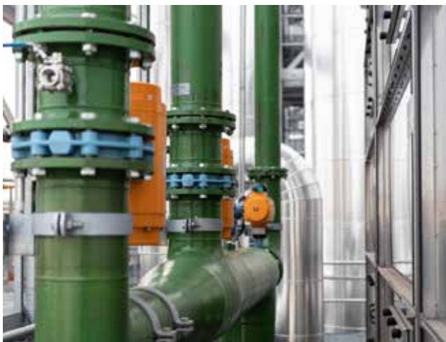
Dynea: piping in RVS met verschillende diameters om het koelwater te transporteren
